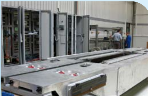
eMASS bei Hysco (CGL) in Dangjiin, Süd Korea mit angepasster Trägerkonstruktion
