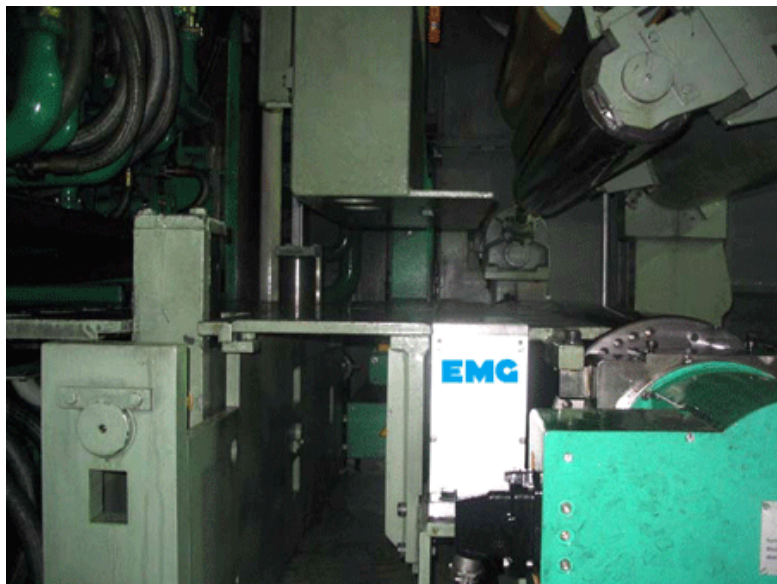
Abb. 5: Die VKI Sensoren im Einsatz
